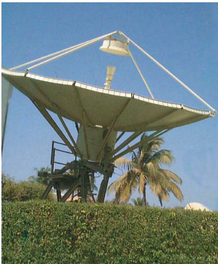
Antenne du réseau de télécommunication par satellite de la BCEAO.
