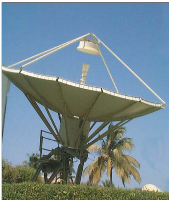
L'antenne du réseau de télécommunication par satellite de la BCEAO.
